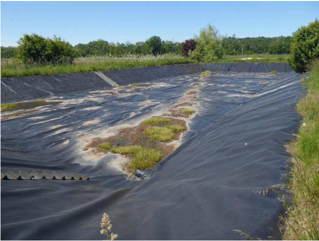
CV16 : Bassin étanche de gestion des eaux pluviales
